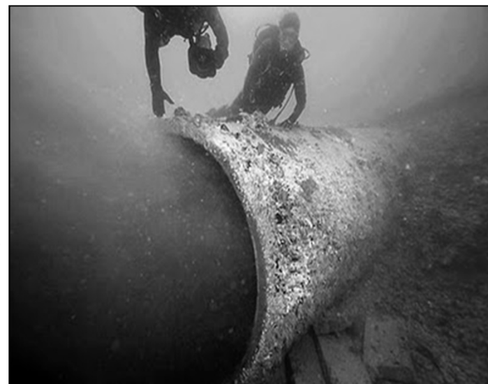
Lançamento, no mar, de esgoto sem tratamento da população da zona sul da cidade do Rio de Janeiro, pelo emissário submarino de Ipanema.
